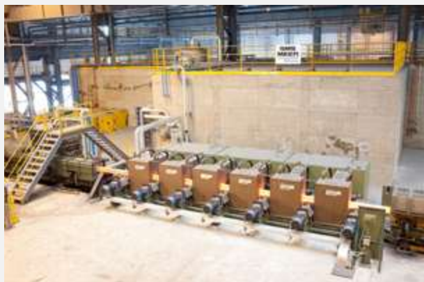
Bild 10: Induktive Erwärmungsanlage mit 6 Induktionsspulen bei Tung Ho Steel in Taiwan (Werksbild SMS Elotherm)
